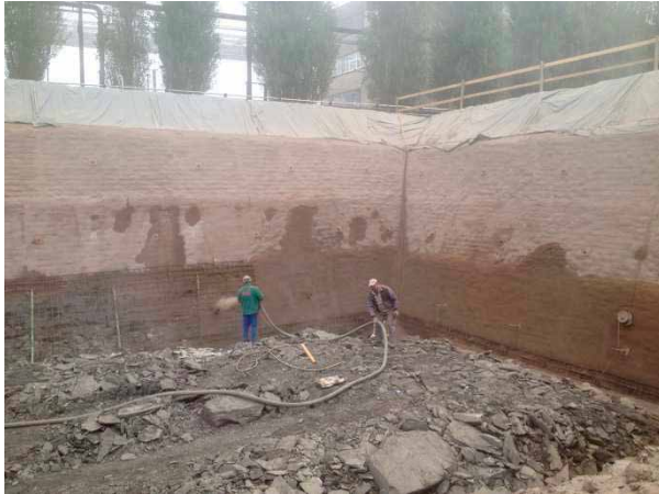
Vue sur le blindage de la fouille dit « paroi cloutée » – application de la gunite en cours
