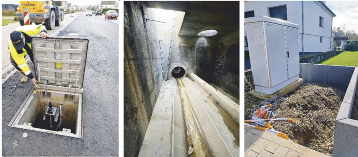
Déversoir d'orage B213 - bd Kennedy
