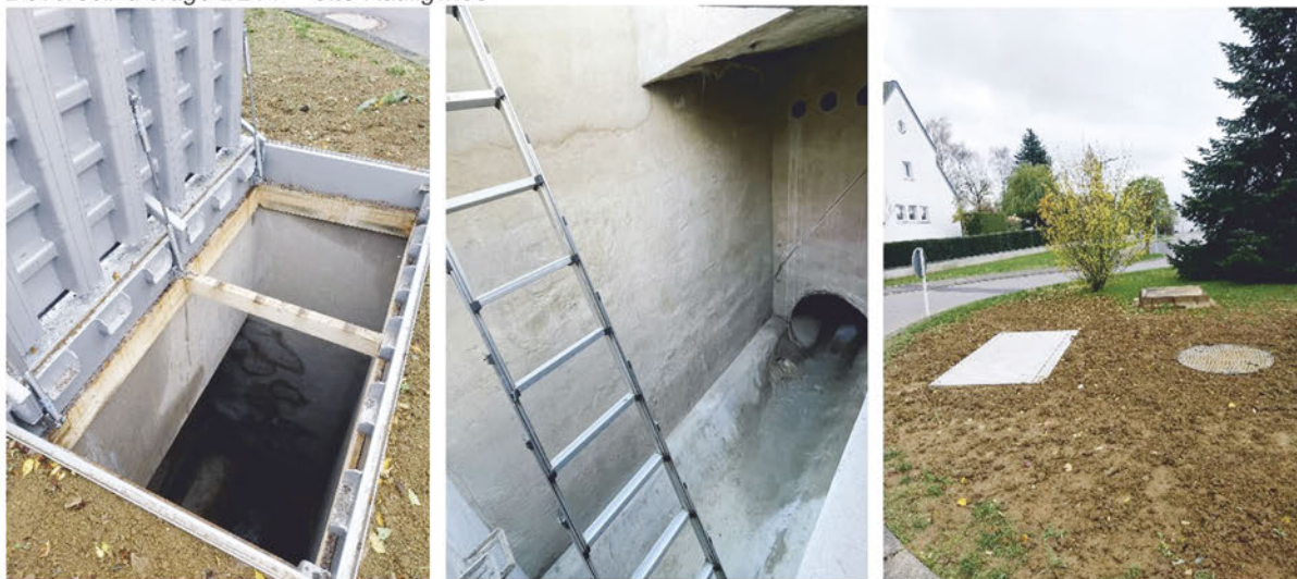
Déversoir d'orage B214 – Cité Kauligwies
